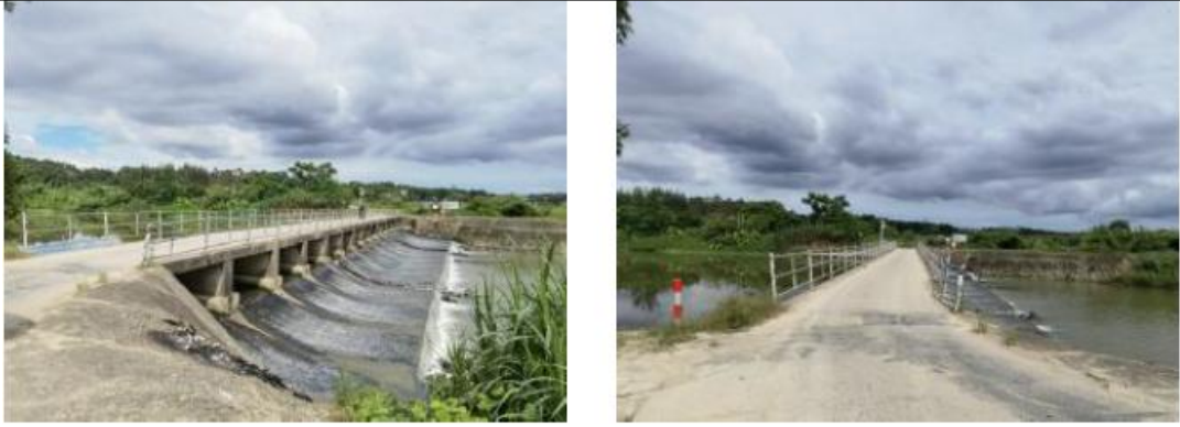
K2+330 现状锦岭漫水桥
